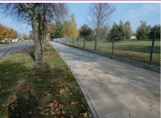
Remont ciągu pieszego na ul. Wincentego Witosa i ciągu pieszo-rowerowego na ul. Woj. Polskiego w Suwałkach, fot. z archiwum ZDiZ w Suwałkach.
